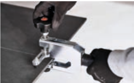
Usare apposite pinze troncatrici per ottenere il taglio ottimale evitando la rottura del materiale.
